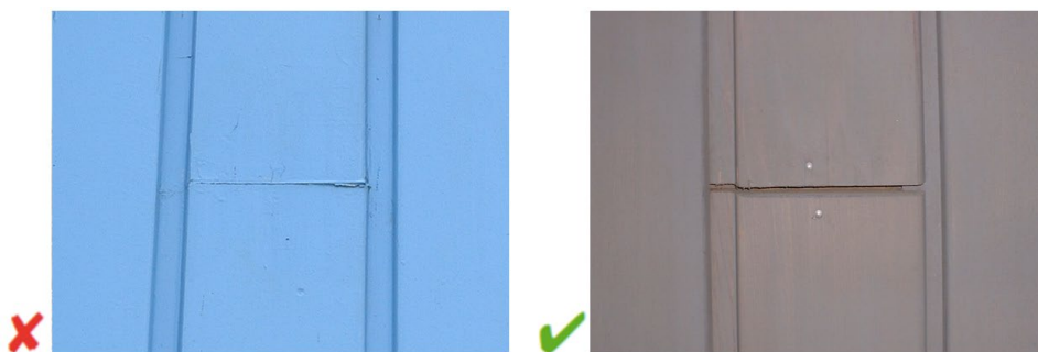
Illustration 8 - Joints bout à bout mal posés (Source: Centrum Hout, 2024)
